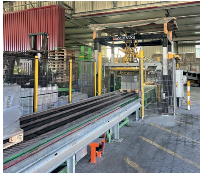
Die fertigen Pakete werden über Rollenbahnen zur Octopus-Stretchwickelmaschine transportiert und anschliessend an der Übergabestelle vom Stapler abgeholt.
